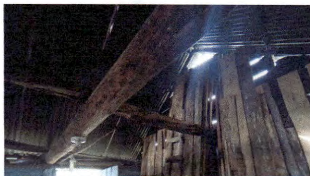
Foto 6: Parte de Muro dañado
