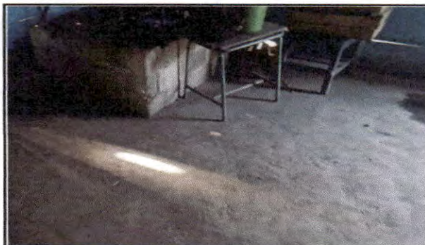
Foto 2: Piso rustico en mal estado
