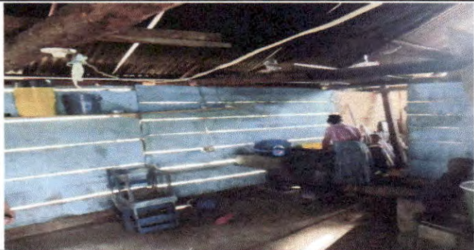
Foto 7: vista interior de cocina con muro sobre puesto de maderia y lamina mal puesta
