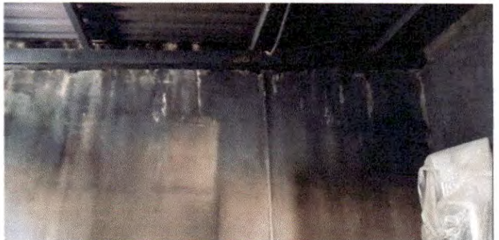
Foto 10: Muro totalmente dañado y con mucha humedad
