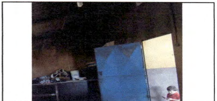
Foto 12: Puerta en mal estado con marcas de corrosión y con agujeros.
